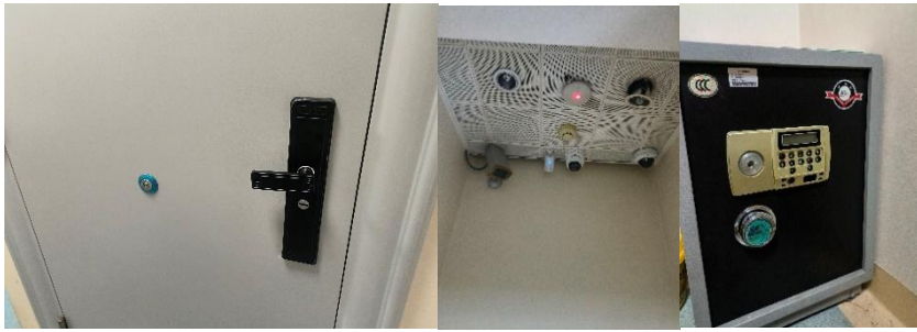
储源室门锁、监控、保险柜等
