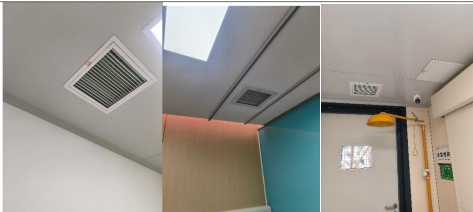
留观病房区域排风系统
